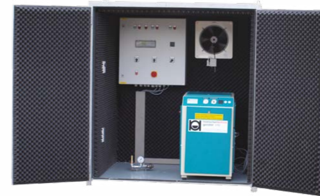
Begehbarer Betongeräteschrank mit einem 7,5 kW Schraubenkompressor und integrierter Pumpensteuerung
