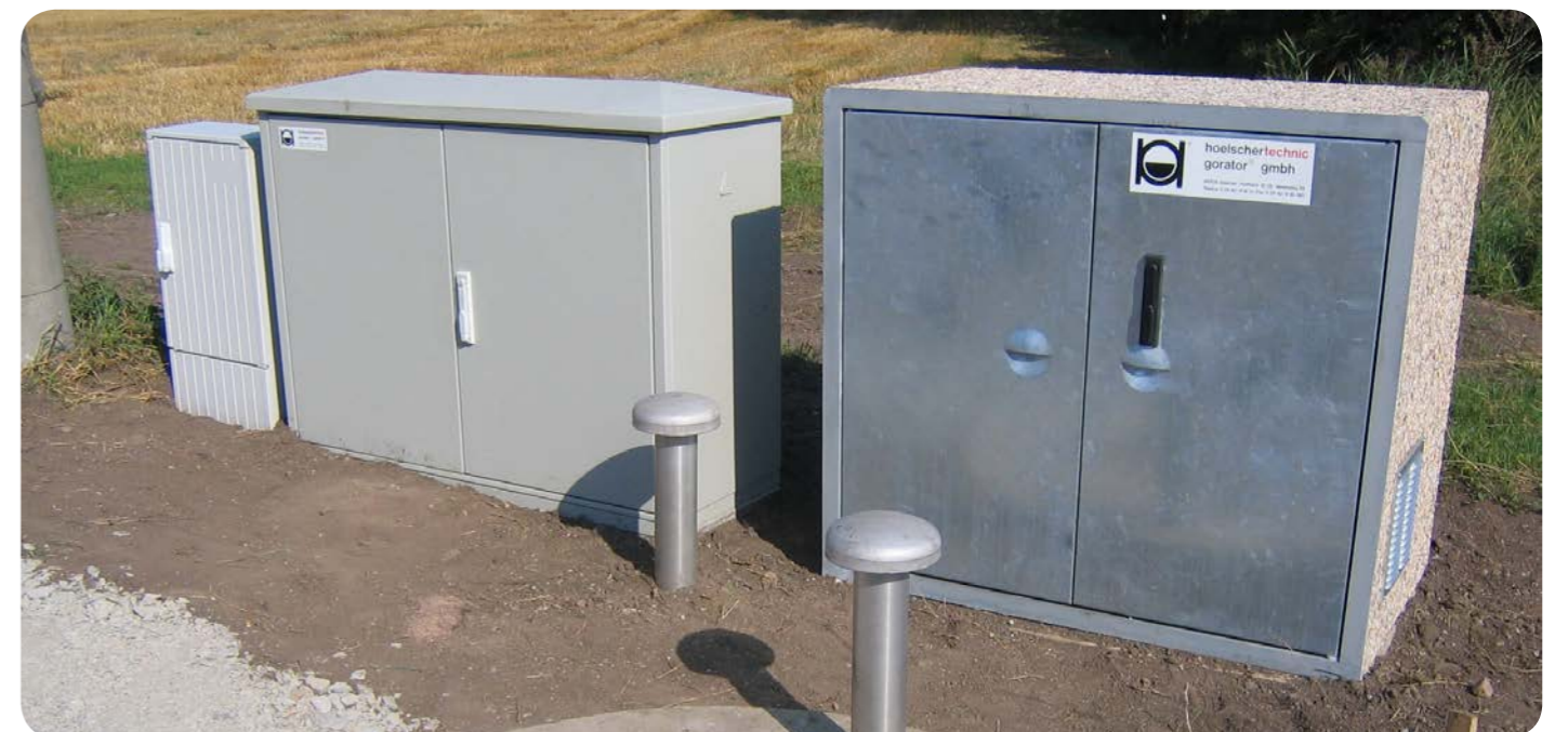
Betongeräteschrank und EVU-Säule und GFK-Außenschrank für Nachblaskompressor und Tauchmotorpumpstation
