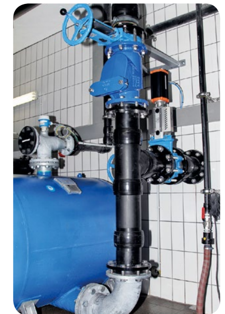
Armaturensatz mit Behälterverrohrung
