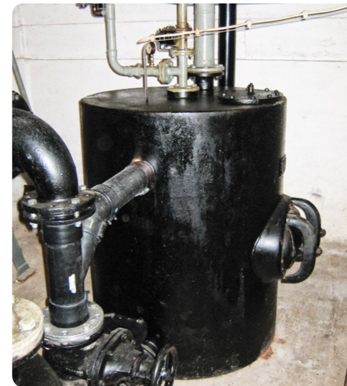
Pneumatische Pumpstation Baujahr 1950
