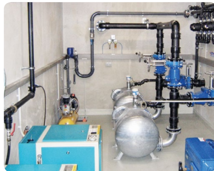
Anlagenraum eines Pumpwerks GULLIVAC® in Kombination mit einer Vakuumanlage
