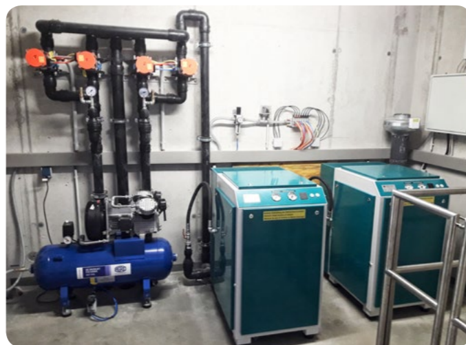
Kompressor mit Prozessluftführung
