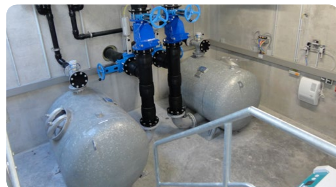
Arbeitsbehälter mit Verrohrung
