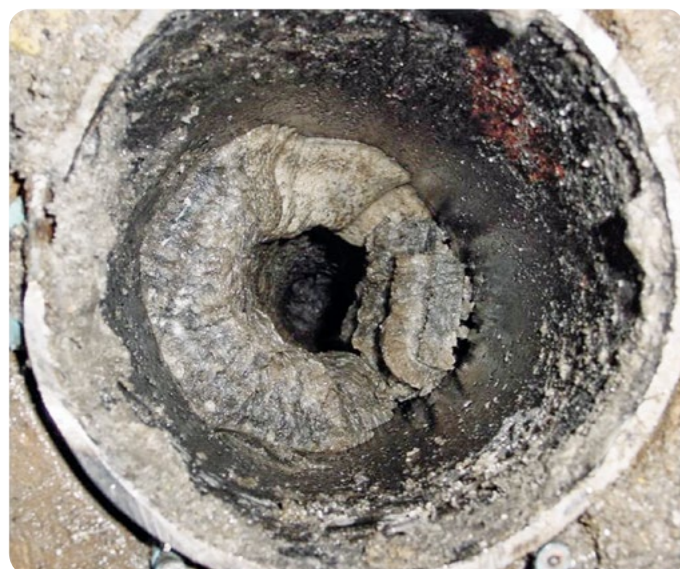
Sielhautbildung in der Rohrleitung
