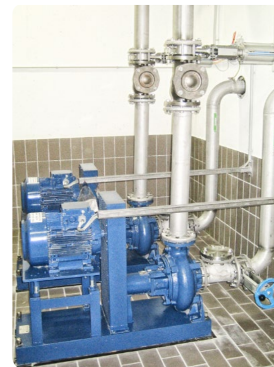
Trocken aufgestellte Pumpen
