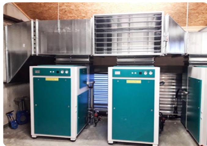
Kompressor mit Abluftsystem
