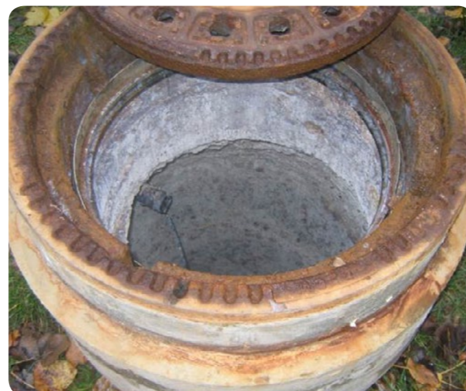
Durch Schwefelsäure-Korrosion angegriffener Betonschacht
