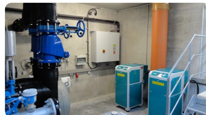
Anlagenraum mit Kompressoren
